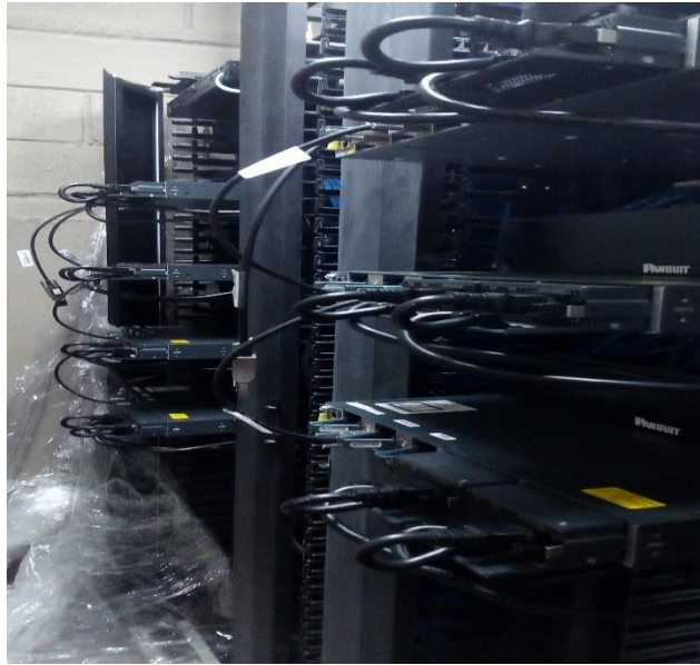
Figura 5. Cuarto de telecomunicaciones nombrado TR 2
